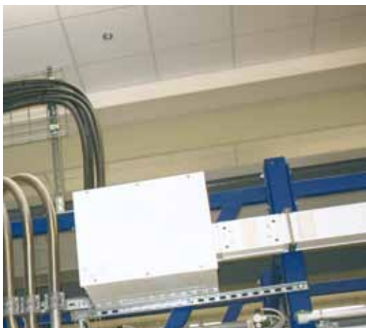
Canalis KS and sprinkler.
